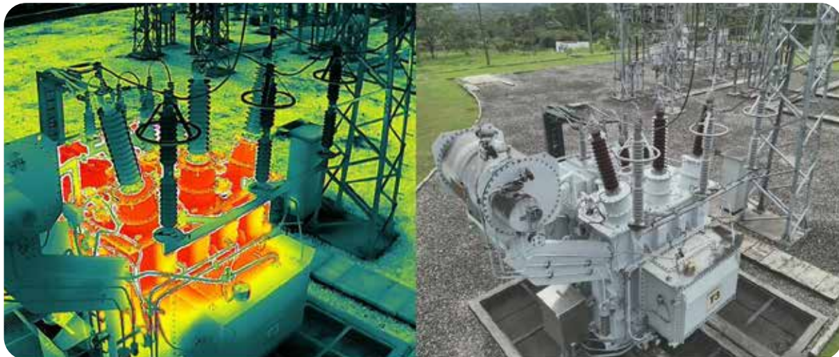
Seccionador de transformador T2 lado 34.5kV Subestación Junín presenta punto caliente - Transformador de Potencia T3
