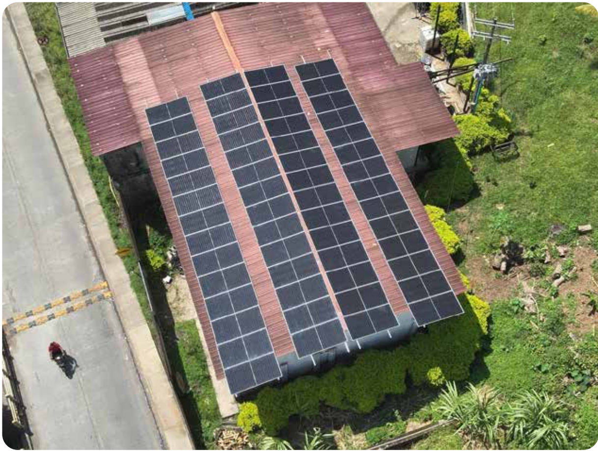
Sistema solar fotovoltaico
