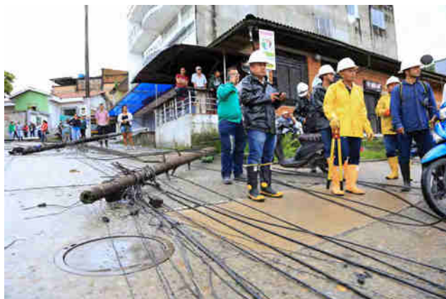
Imagen 12. Varios kilómetros de redes eléctricas destruidas y el efecto dominó que afectó postes de barrios aledaños al desastre.
