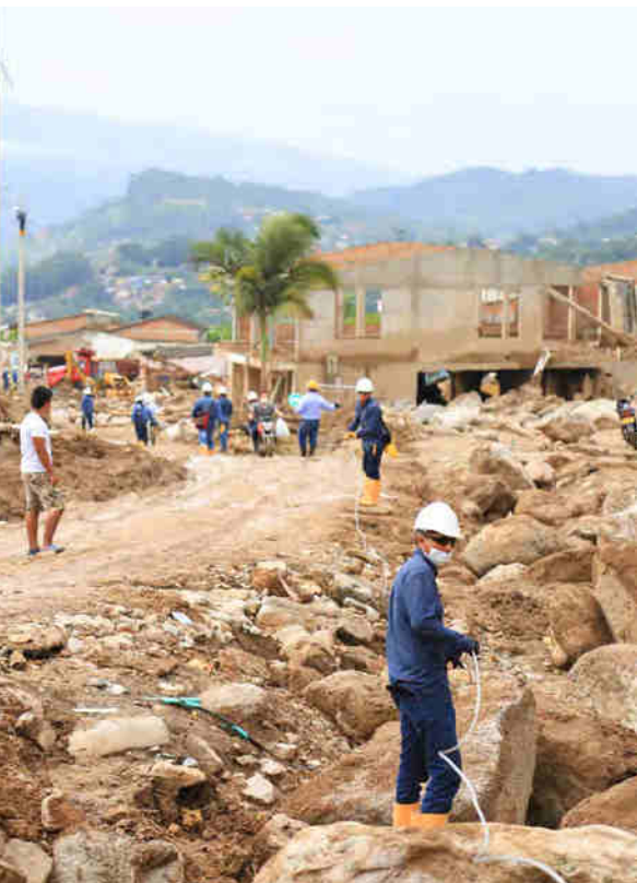
Imagen 37. Es necesario reconstruir 34 kilómetros de redes de media y baja tensión.
