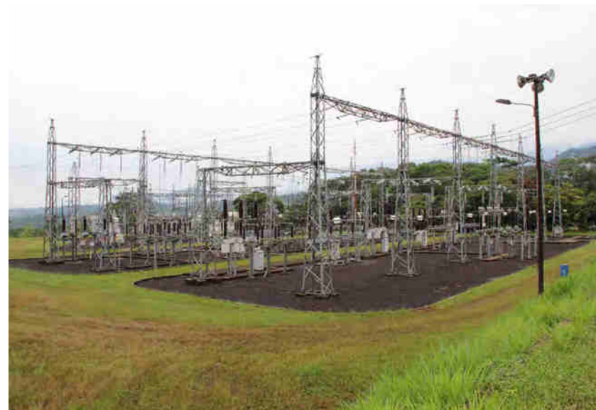
Imagen 16. Subestación de Junín antes de la avalancha.
