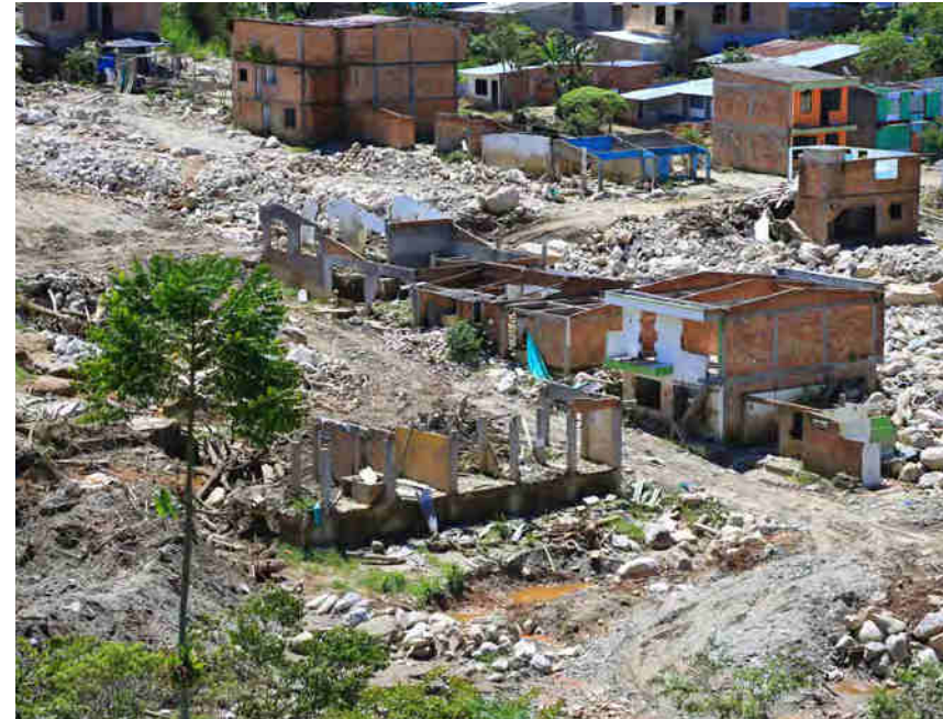
Imagen 49. Sector del Barrio San Miguel después de la avenida torrencial, la pérdida de usuarios de la E.E.P. S.A. E.S.P. asciende a 1.512..
