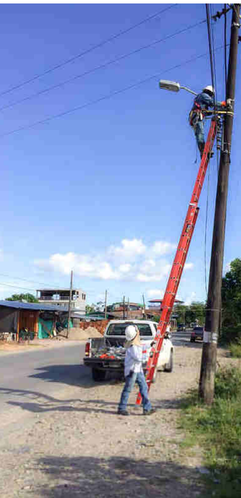
Imagen 55. Instalación de 60 lámparas LED para el sistema de alumbrado público de Villagarzón.
