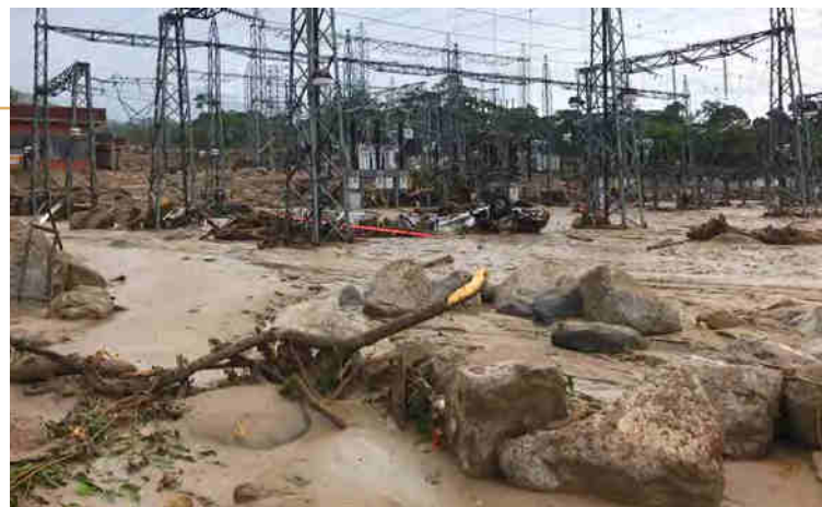
Imagen 8. Activos o equipos eléctricos de potencia que permitían el transporte de energía eléctrica.
