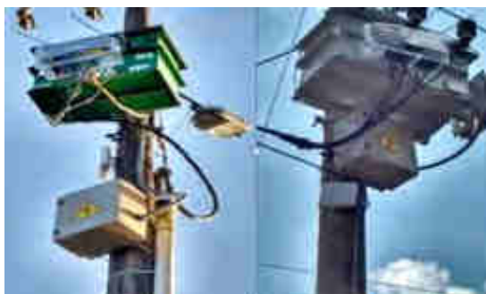
Imagen 48. Macro medidores instalados en Orito.
