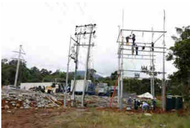
Imagen 38. Pórtico reconectores 34,5 kW – Subestación Móvil
